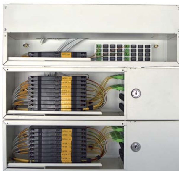
Dall'alto, il Modulo Antenna e lo CSOE. Ogni modulo CSOE serve otto unità immobiliari.
